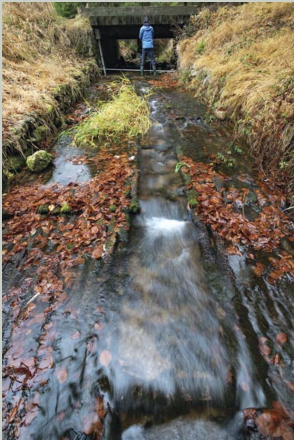
Podzimní měření průtoku na Kaplickém potoce.
