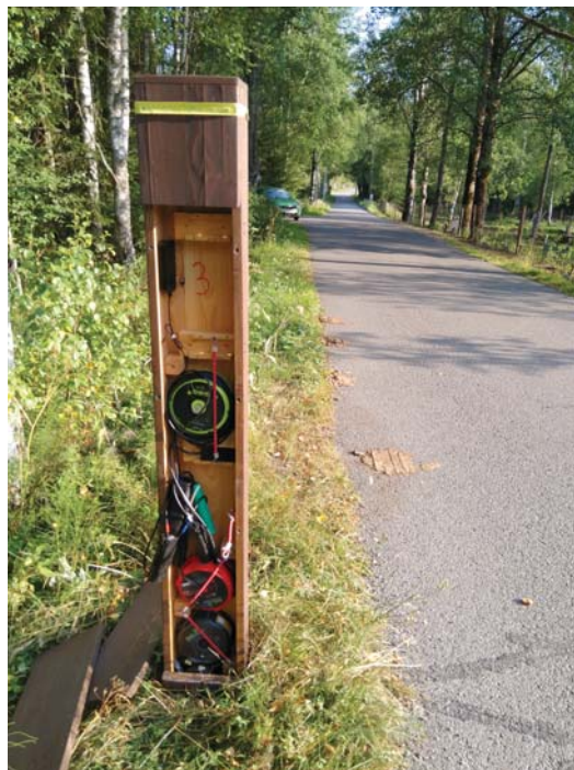
V dřevěném sloupku na kraji cesty umístěný sčítač. (Foto: Josef Štemberk)
