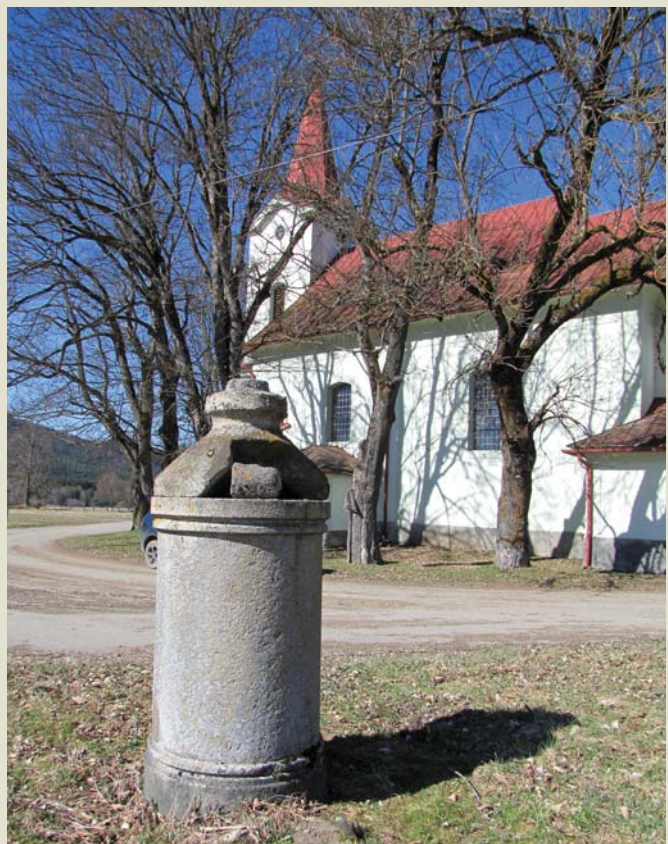
Rozvaděč v obci Pěkná. Foto: Helena Flíčková
